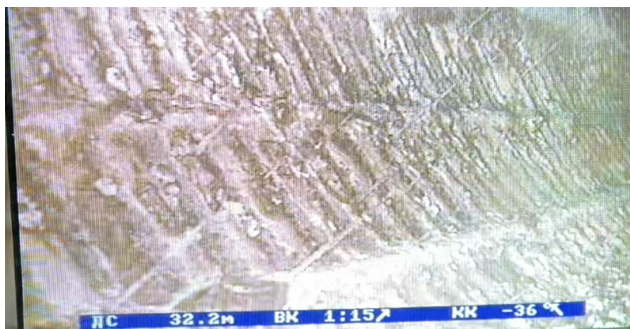
Рис. 1 Отслоившиеся зоны бетона и оголенная арматура
